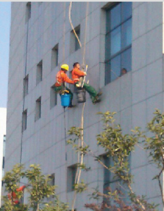
4.外包单位清洗玻璃幕墙人员在登高作业时未佩戴安全绳。
