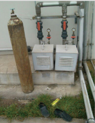
2.外包单位动火储气瓶固定在压力管道上，非常危险。
