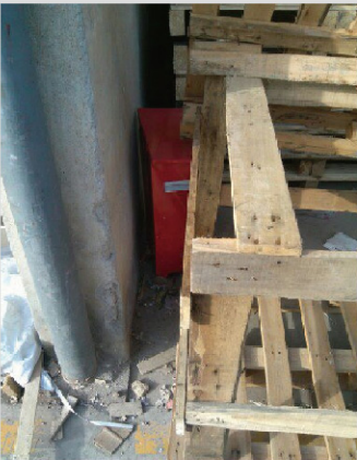
3.垃圾站废旧托盘阻挡灭火器。
