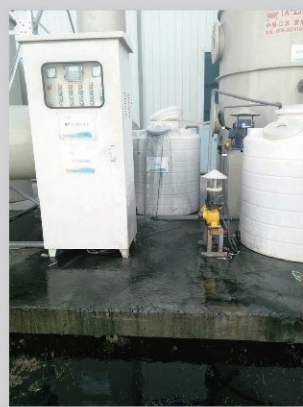
1、加药时无人看守，导致药液泄露，严重影响厂区环境并存在严重浪费现象。
