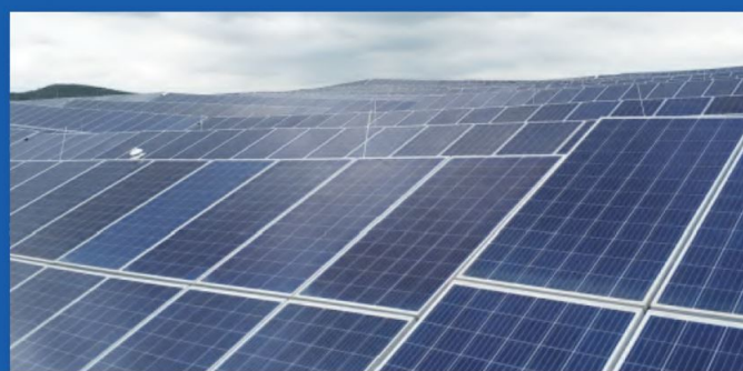
ACME SOLAR HOLDINGS LIMITED 印度150MW项目
