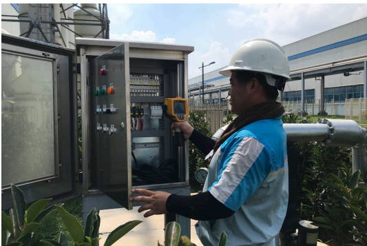
环保组秦浩，在下午两点天气最热的时间段，正专心致志检查尾气处理设备的电源控制箱运行情况，他坚毅的眼神诠释着爱岗敬业、坚守岗位、不畏酷暑的精神。
