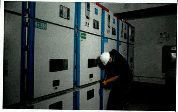
设备总电切断
